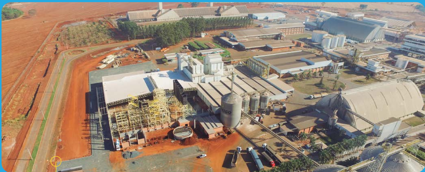
NOVA FÁBRICA RAÇÃO (RIO VERDE) - Construção da fábrica para ração de bovinos, no parque industrial, com capacidade para 120 ton/hora, automatizada.
