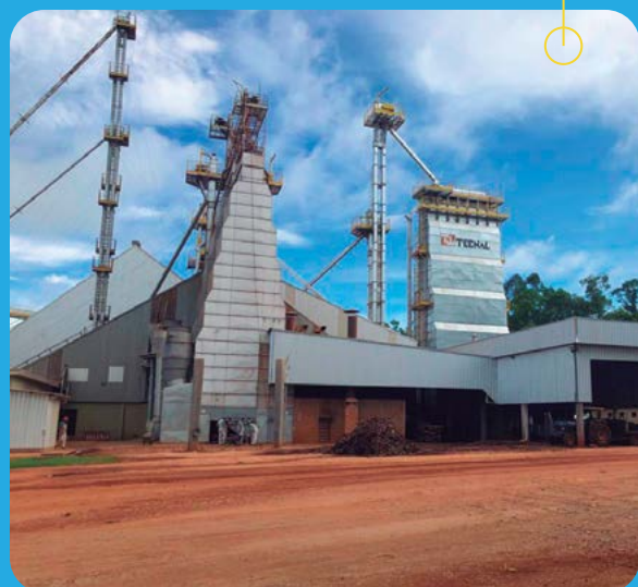
ARMAZÉM (INDIARA) - Construção de um armazém graneleiro com capacidade para 60.000 toneladas, (1.000.000 sacas), expedição com balança rodoviária de 30 metros. Reforma e modernização da casa de máquinas, inclusive automatização de toda unidade.
